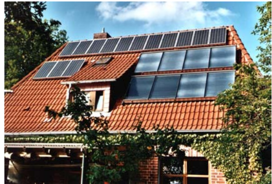
Photovoltaik-Anlage des Technologiezentrums Delmenhorst.
